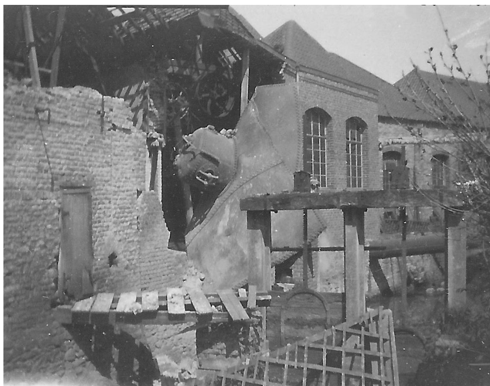
Photo RD 4549. L'enveloppe de la chaudière du remorqueur tombée dans la salle des machines de l'usine Carton.
